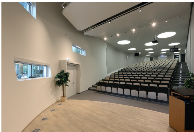
Обзор круглой аудитории Maximum на стадии выполнения отделочных работ (Фото: Knauf / Halama)
