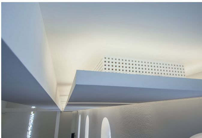
Потолочные сегменты из акустических плит Knauf Тесторанел под штукатурку поглощают звук внутри церкви.
