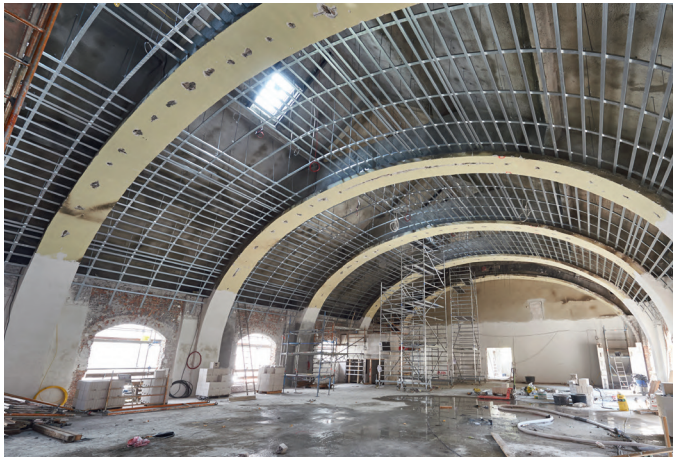
Подконструкция потолка, к которой крепились перфорированные гипсокартонные плиты КНАУФ-Акустика, расположена между несущими рамами
