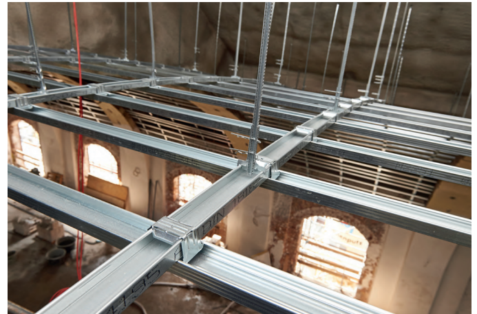
Изогнутые основные профили конструкции подвесного потолка были предварительно изготовлены на заводе с соблюдением требуемых радиусов и поставлены на строительную площадку
